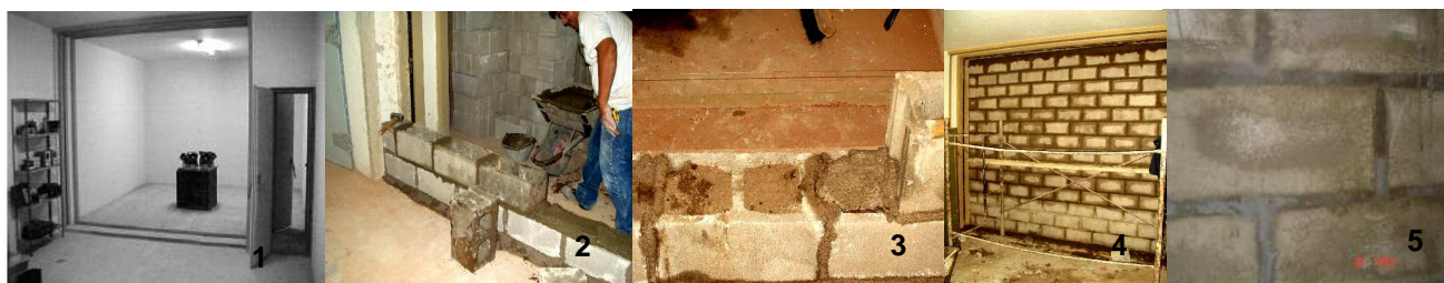
Figura 4: construcción del muro en el Laboratorio de Sonido UTN- Reg. Mendoza: cámara de sonido (1), pegado de los bloques (2), relleno con arena gruesa (3), cierre de la cámara (4) y bolseado de las juntas (5).
